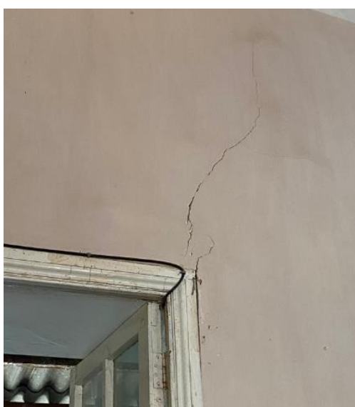
Fotografía 5. Grieta diagonal de 3mm de espesor, ubicada en esquina de ventana
