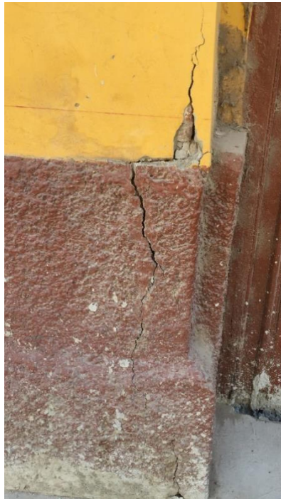
Fotografía 23: Grieta sobre muro de fachada de casona
