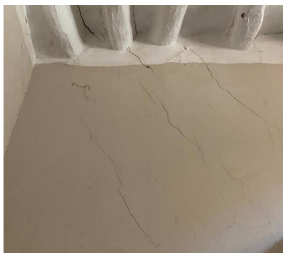
Fotografía 4. Grietas diagonales de 3mm de espesor sobre muro
