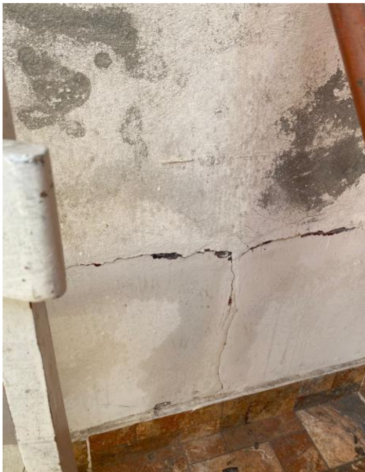
Fotografía 25: Grieta horizontal sobre muro
