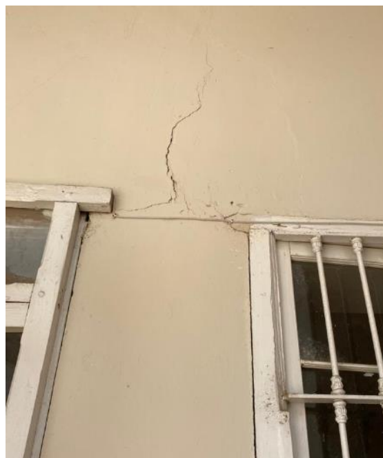
Fotografía 2. Grieta de 3mm de espesor, ubicada en la esquina de ventana
