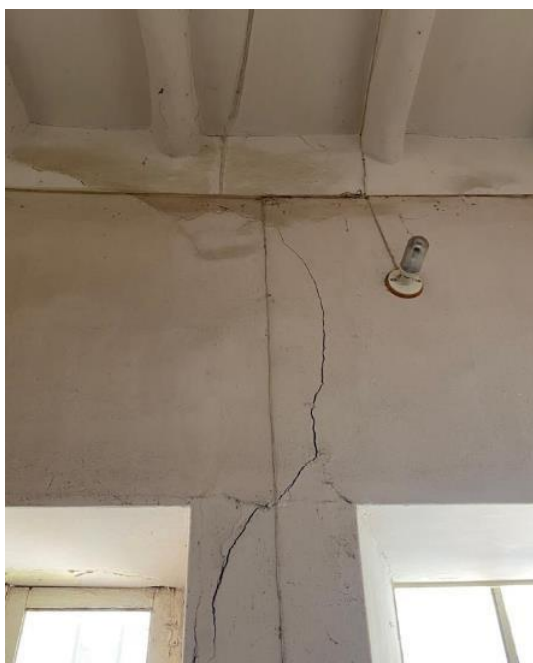
Fotografía 3: Grieta vertical de 4 mm sobre el muro.
