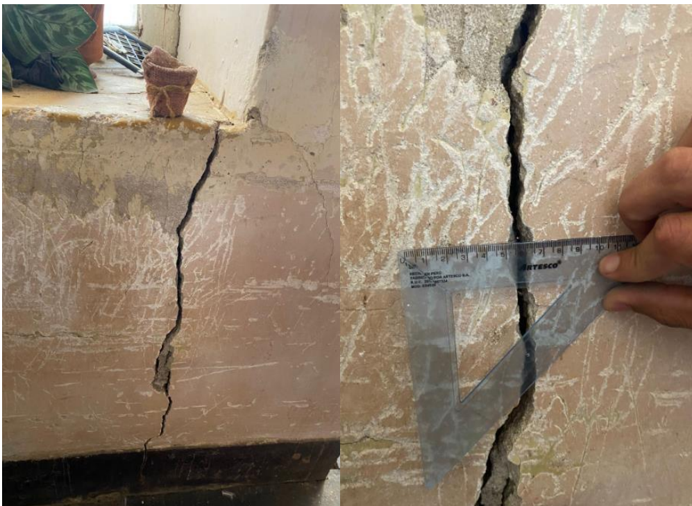
Fotografía 24: Grieta de 1.5 cm sobre alfeizar
