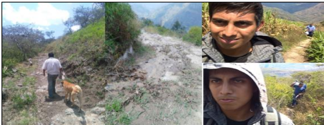
Fotografía N°: 5 Estado superficial del camino de herradura existente.
